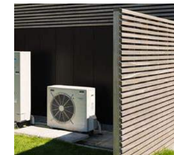
Warmtewisselaar uit het zicht door meeontworpen afscheiding
